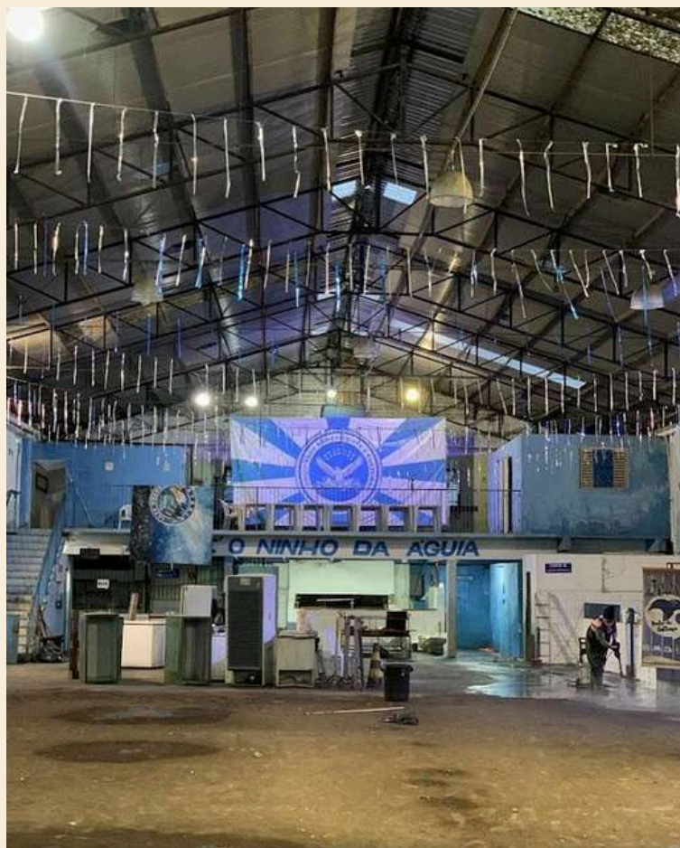
Figura 10: Quadra de SBC Bambas da Orgia em processo de recuperação (2024). Fonte: Acervo do Sépia UFRGS.
